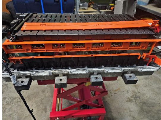
Akku geöffnet, Seite mit den Stromschienen
